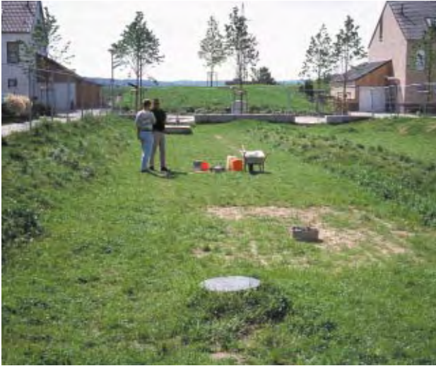
Funktionsüberprüfung schadhafter Versickerungsmulde
