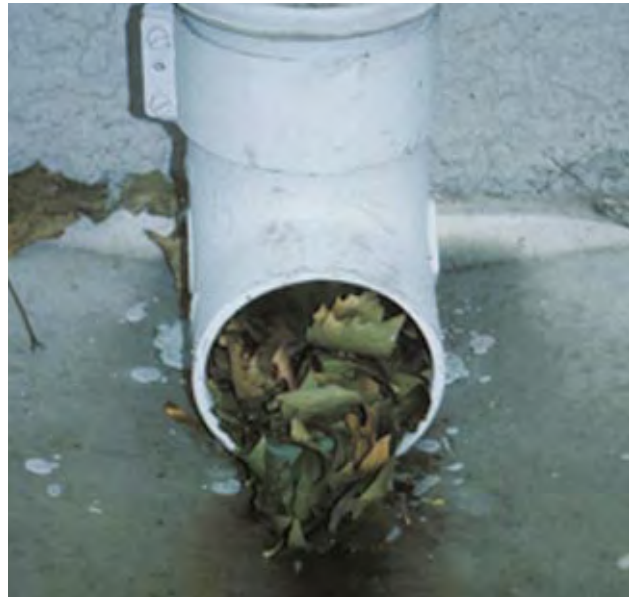
Ablagerungen aus der Dachrinne im Fallrohr
