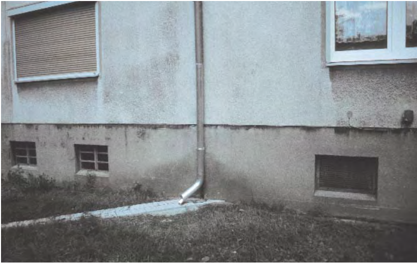
Vernässung der Hauswand im Sockelbereich
