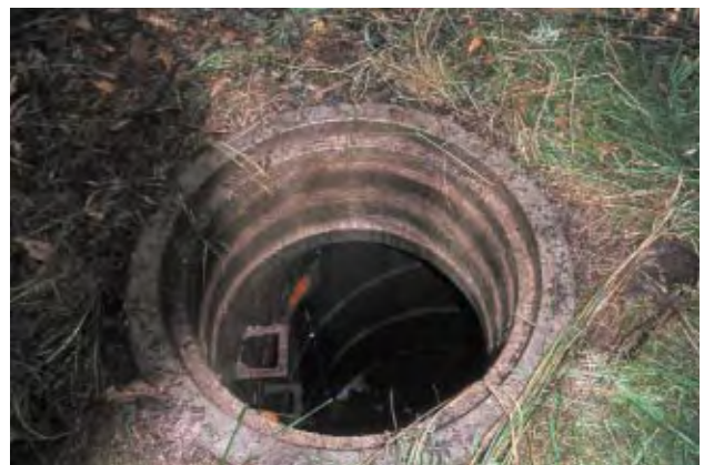
Schacht mit Anschluss an Drainrohr (Rigole)
