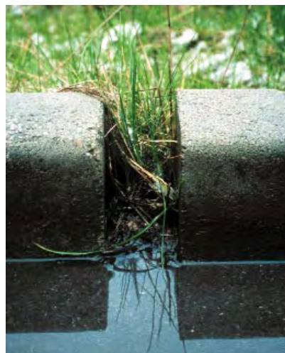
Rückstau durch Vegetationsaufwuchs in Hochbordlücke
