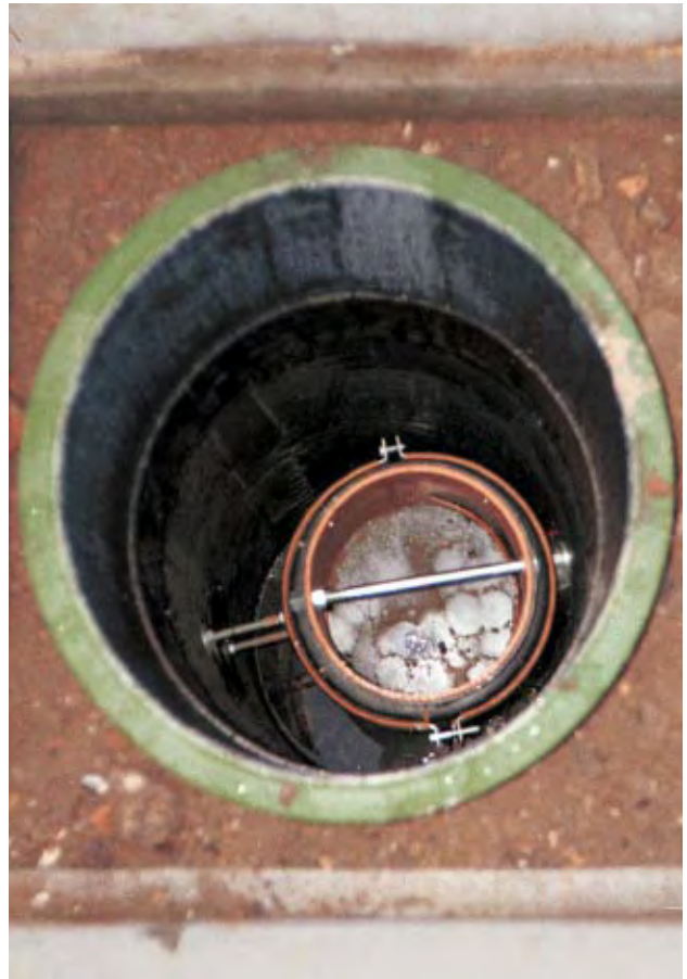
Drosselschacht mit überfahrbarer Einfassung/Abdeckung in Betrieb
