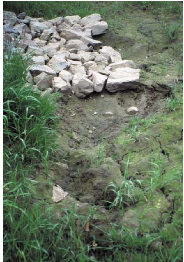
Erosionsschäden in Mutterbodenschicht
