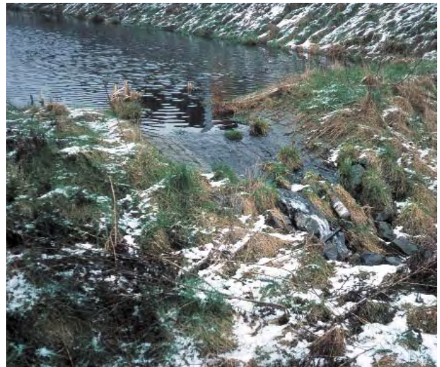
Notüberlauf in Betrieb
