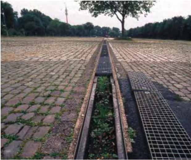
Verringerung Rinnenquerschnitt durch Ablagerungen
