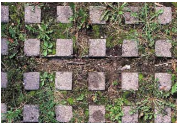
Rasengitterstein – geschädigte Vegetation
