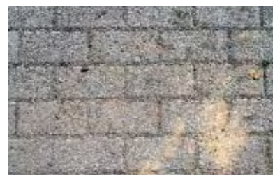
Verschmutzter Pflasterbelag (Lehm)
