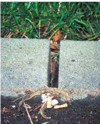
Ablagerungen vor zu schmaler Lücke verursachen Rückstau
