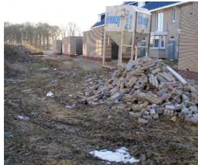
Bauschutt und Spuren schwerer Baumaschinen in den zukünftigen Versickerungsflächen
