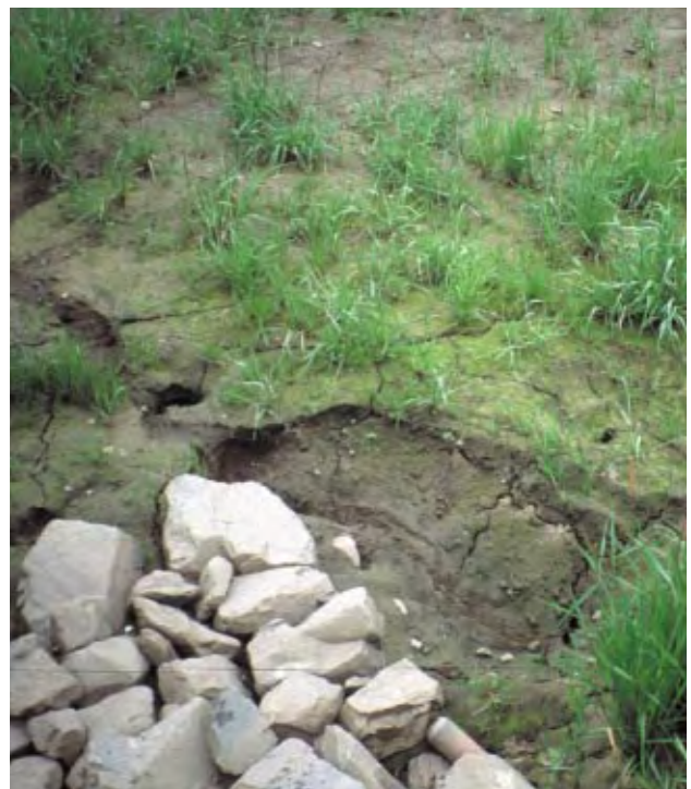
Trockenrisse in noch nicht vollständig bewachsener Mutterbodenschicht
