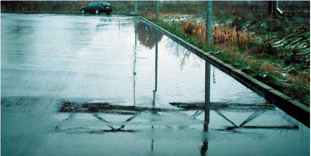
Wasserrückstau wegen verstopfter Ableitungslücken im Hochbord
