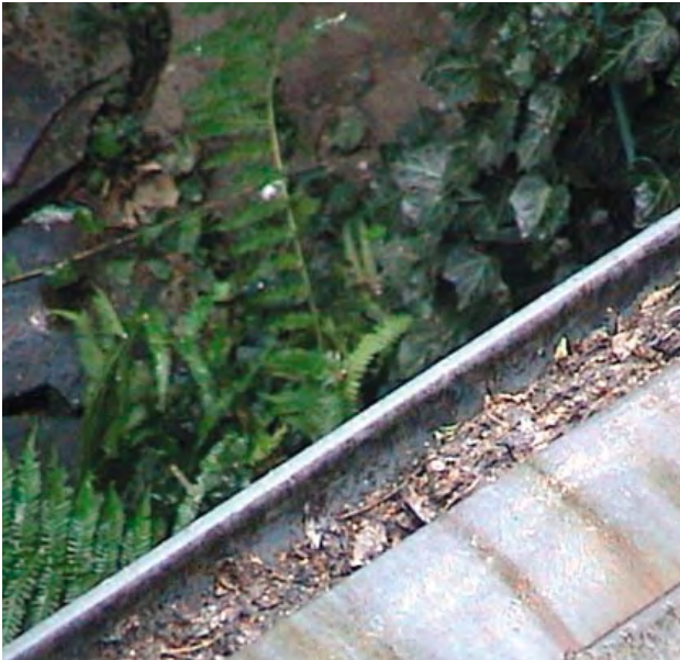
Ablagerungen in Dachrinne
