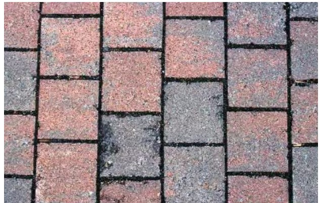
Sickerfugenpflaster 8 Jahre alt vor Reinigung
