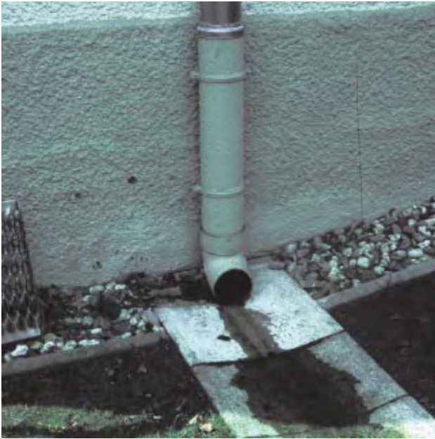
Stabiler, kurzer Fallrohrkrümmer aus Gussstahl, passgenau mit Rinnstein verbunden. Fallrohr im Sockelbereich doppelt fixiert.
