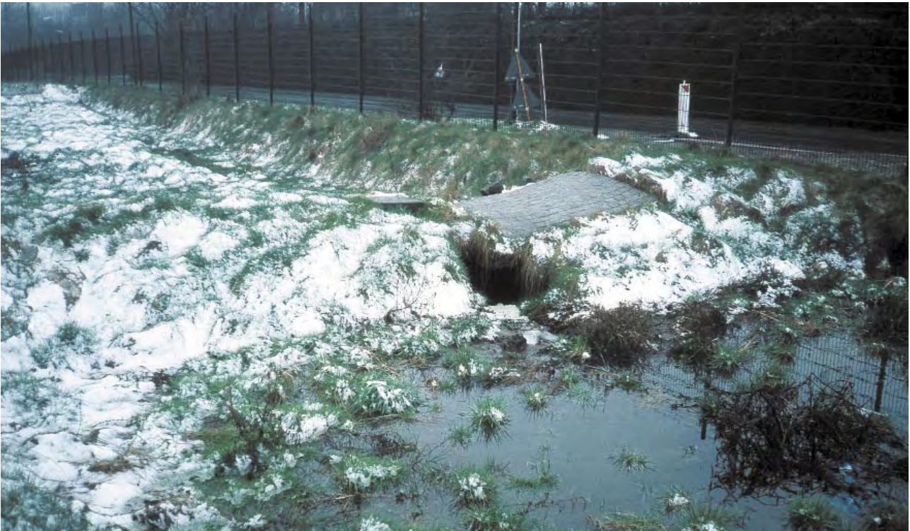
Unterspülter und absackter Notüberlauf
