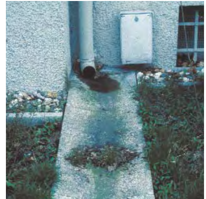
Abflussbehinderung durch Sedimentablagerung/Wulstbildung
