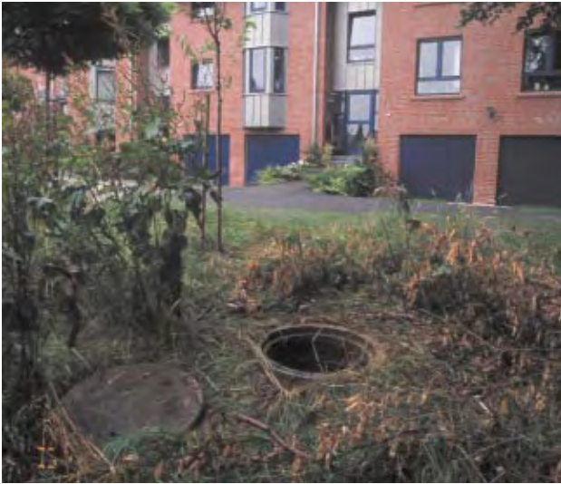
Sickerschacht in Wohngebiet
