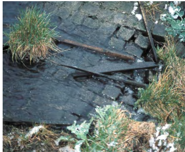
Auswaschungen im Pflaster gefährden die Standfestigkeit
