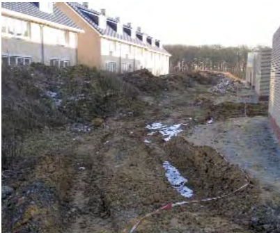
Spuren schwerer Baumaschinen in den zukünftigen Versickerungsflächen
