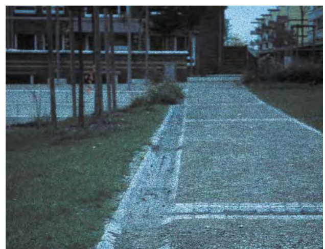
Sedimenteinträge von angrenzender wassergebundener Decke
